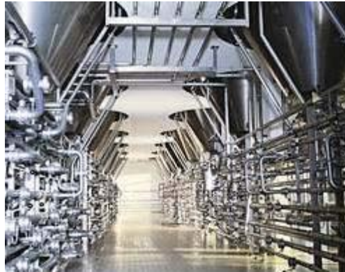
PAINÉIS E VÁLVULAS EM AÇO INOX
